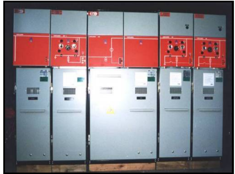
Equipamiento para medición en MT (Media Tensión)
